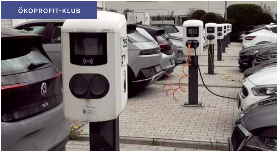
Der Elektrofuhrpark auf dem firmeneigenen Ladeparkplatz mit Batteriespeichersystem
