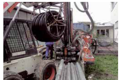
Mit Geothermie kühlen und heizen
