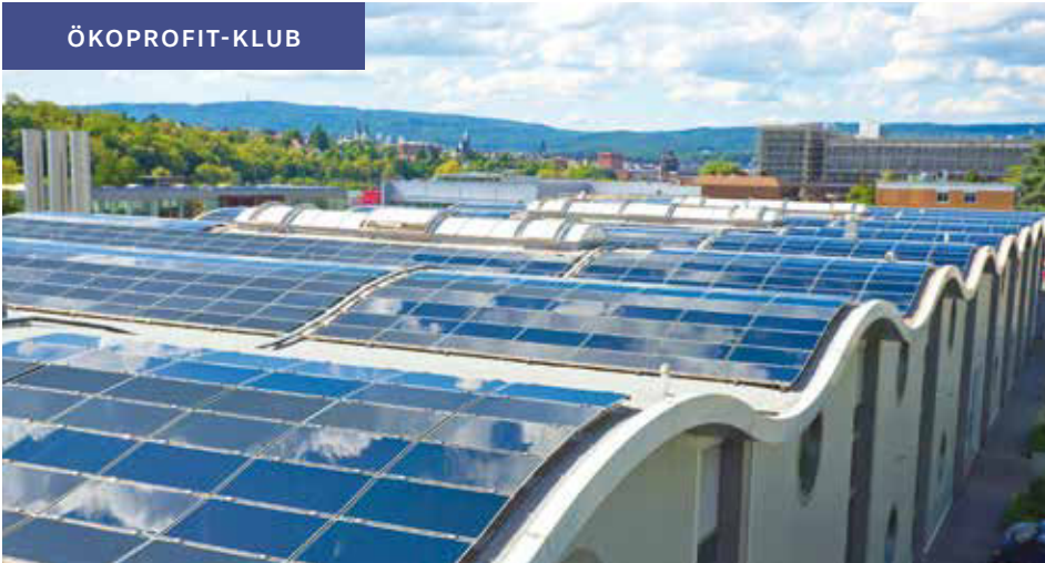
147,68-kWp-Photovoltaikanlage auf dem Lagergebäude der ESWE Versorgungs AG
