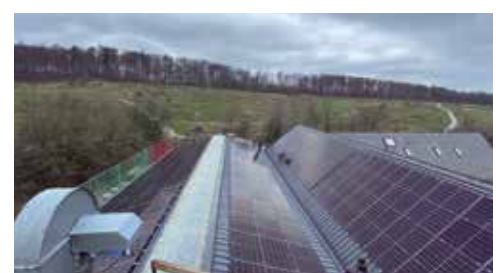
Neue Photovoltaikanlage auf dem Dach der Maschinenhalle
