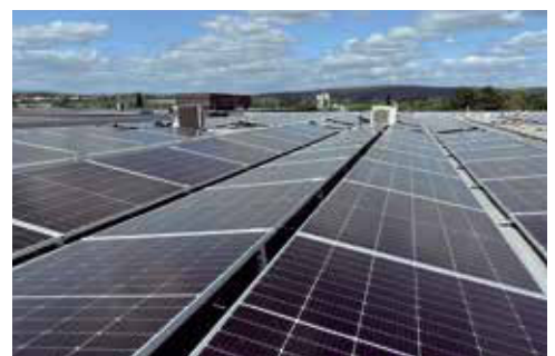
Photovoltaikmodule auf dem Dach des Hauptgebäudes
