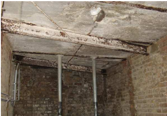
Decke Untergeschoss: Stahlträger korrodiert
